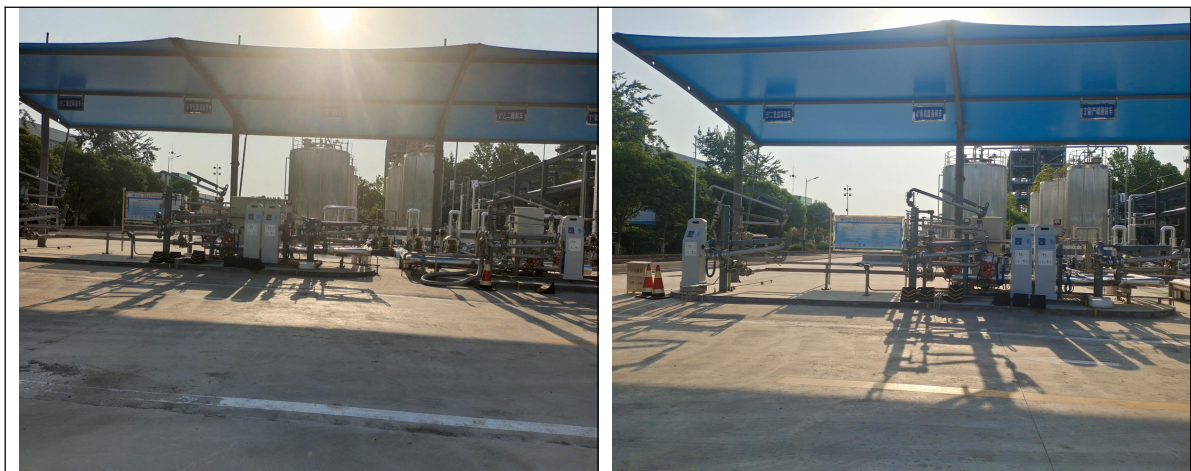
二期新建液下鹤管装卸车系统，并设有平衡管
