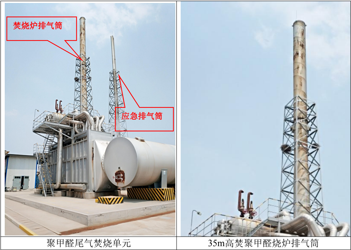
图 4.1-1 废气治理设施
