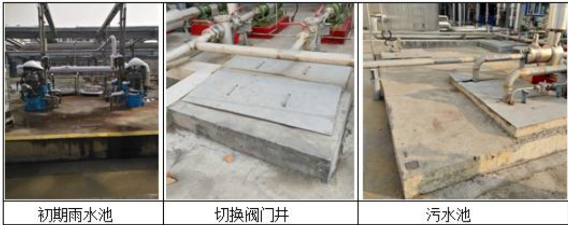
图 4.1-7 废水处理装置
