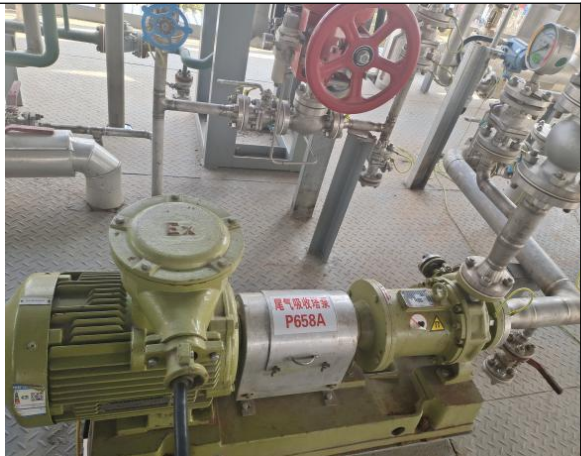
二期新增尾气吸收塔泵P658A
